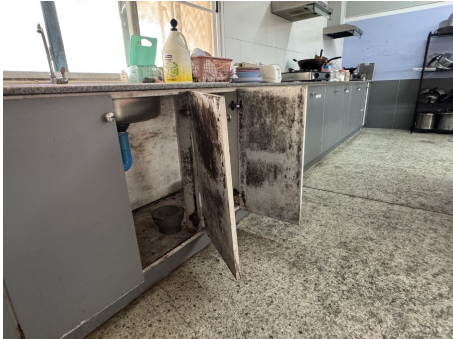
ห้องปฏิบัติการงานครัว (อ่างล้างไม้อัดผุ, ขัดพื้นห้องครัว)
