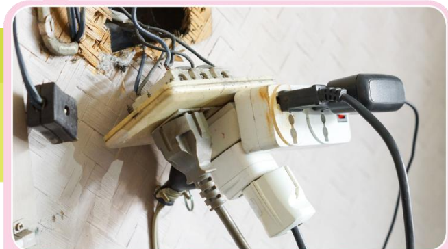
อันตรายจากไฟฟ้า
