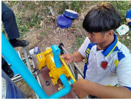
รูปที่ 3 การติดตั้งระบบการจ่ายน้ำเพื่อการเกษตร สื่อสารระยะไกล
